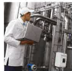
Capteurs et logiciels complètent l'inspection de l'installation.
